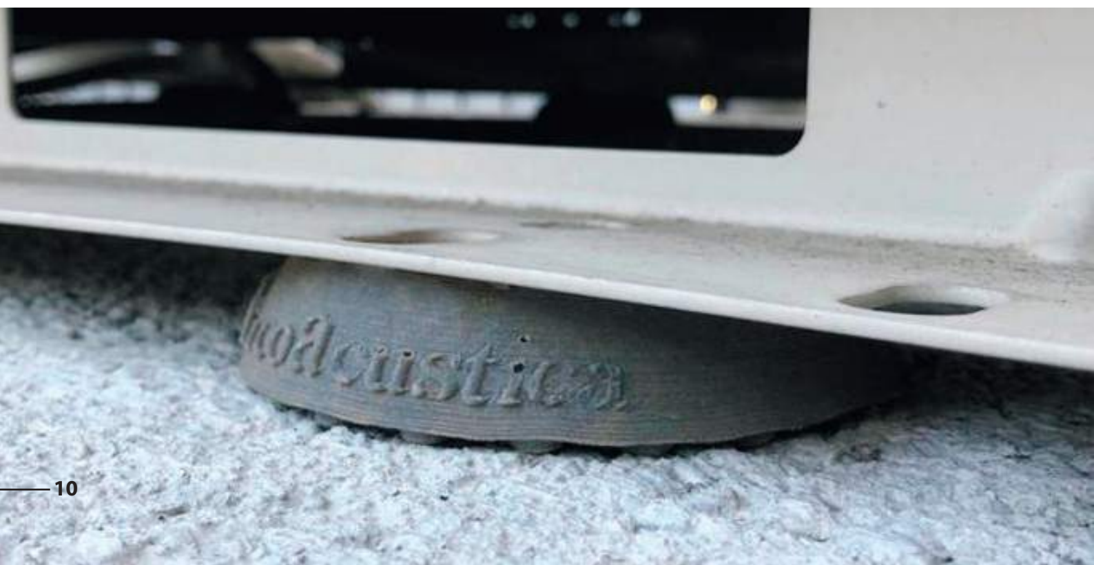
Arco Ci.Emme - forzante pompa di calore - provincia di Roma
