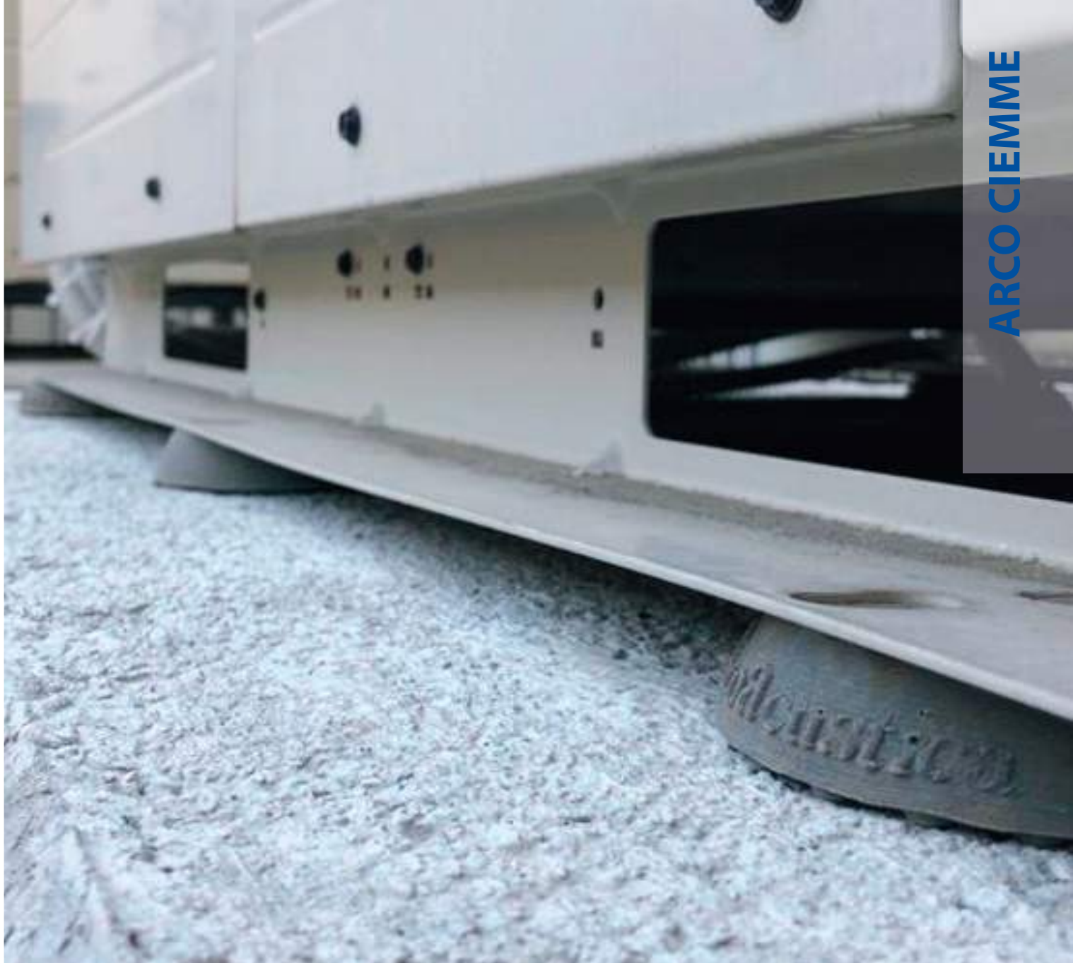
Arco Ci.Emme - forzante pompa di calore - provincia di Roma
