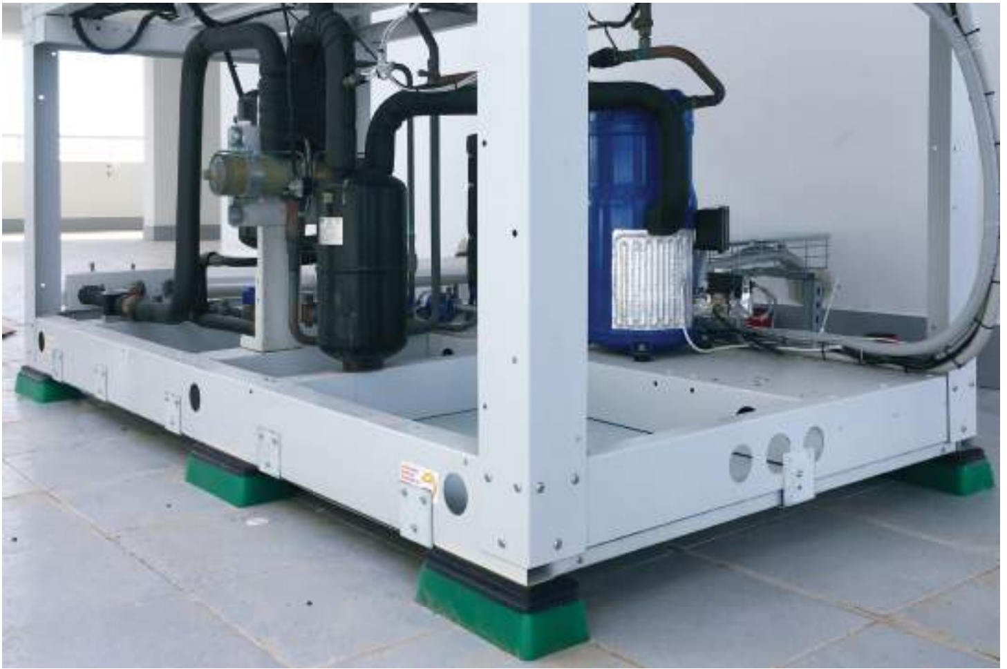
Arco Green Damping - forzante pompa di calore provincia di Bari
