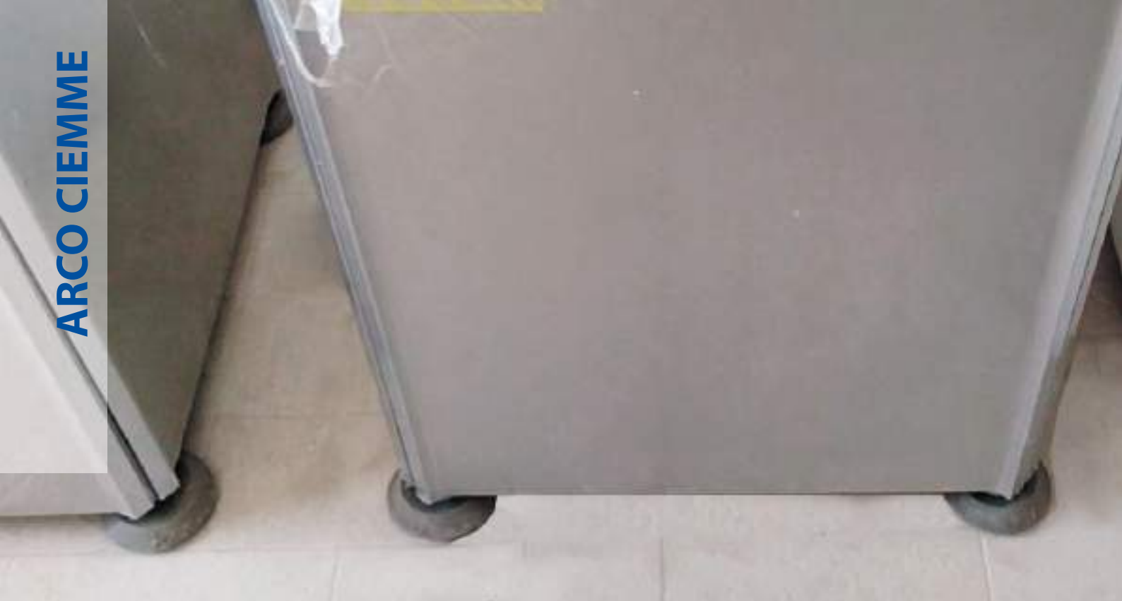
Arco Ci.Emme - forzante pompa di calore - provincia di Grosseto
