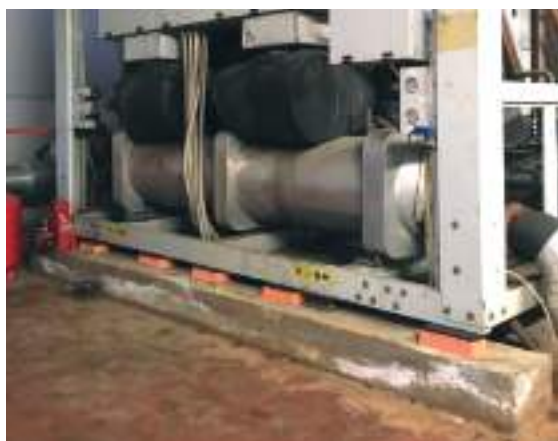
Arco Orange Damping (gruppo frigorifero) provincia di Bologna
