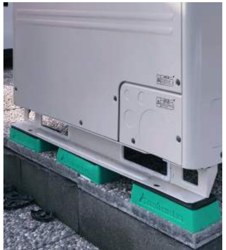
Arco Green Soft Damping - forzante pompa di calore provincia di Bologna
