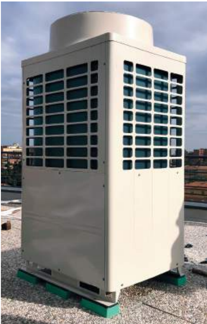
Arco Green Soft Damping - forzante pompa di calore provincia di Bologna
