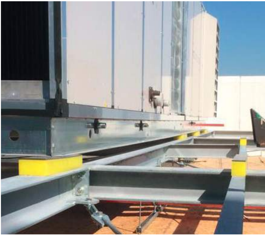
Arco Yellow Damping - forzante unità trattamento aria provincia di Bologna
