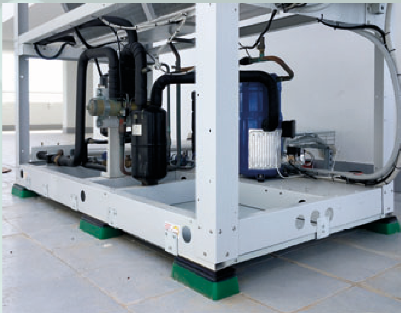
Arco Green Damping - forzante pompa di calore provincia di Bari
