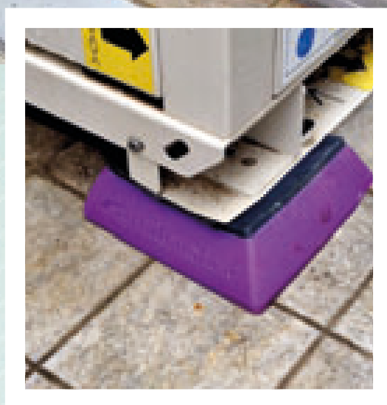
Particolare posizionamento supporto
