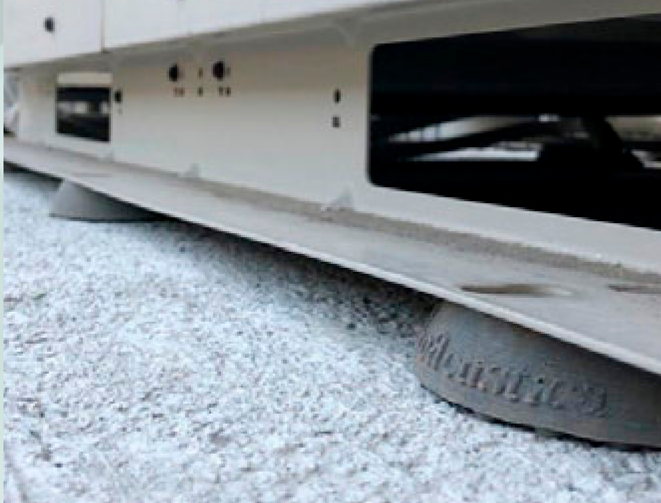
Arco Ci.Emme - forzante pompa di calore - provincia di Roma
