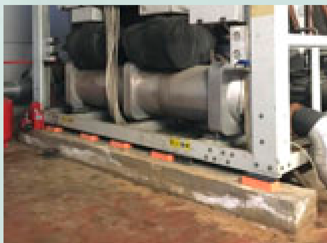
Arco Orange Damping (gruppo frigorifero) provincia di Bologna
