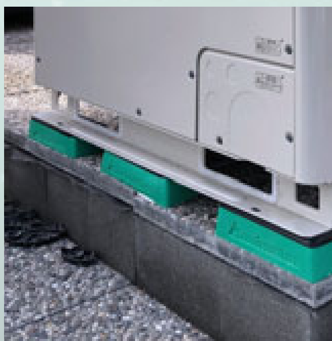
Arco Green Soft Damping - forzante pompa di calore provincia di Bologna
